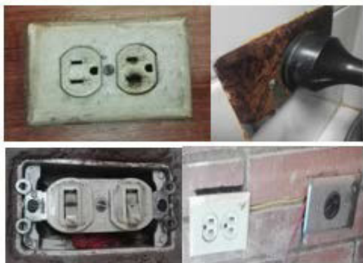
Figura 2. Instalaciones en mal estado. Fuente: Autores.
