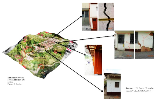
Figura 2. Afectaciones por fracturamiento e inclinación en la infraestructura del área urbana del municipio de Tenza. Fuente: [1].
