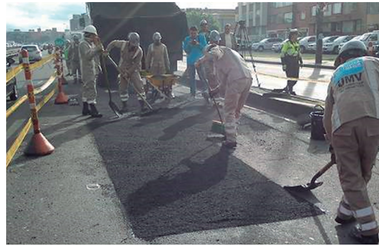
Figura 1. Método parcheo convencional: mezcla asfáltica en caliente Fuente: propia Bogotá Av. Boyacá por Cll 55
