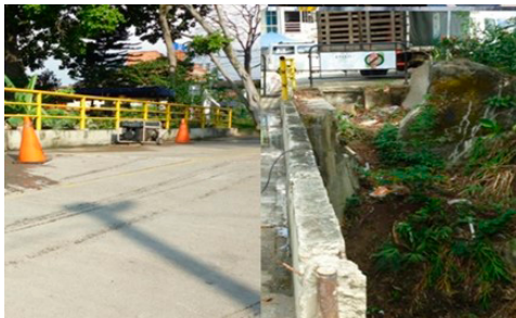
Figura 7. Lesiones en la superestructura y el tablero Fuente: autores del proyecto.
