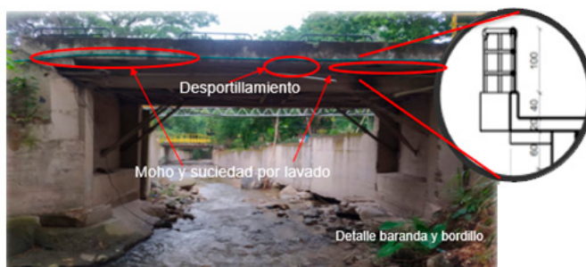
Figura 9. Vista Lateral de las lesiones en Vigas y Riostras. Fuente: autores del proyecto.
