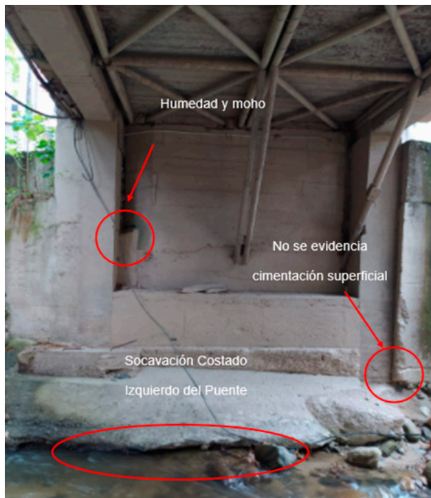
Figura 10. Detalles de la socavación y estado de la armadura de soporte de la subestructura y el tablero. Fuente: autores del proyecto.
