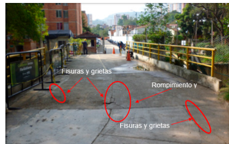
Figura 8. Lesiones en las losas de aproximación y juntas. Fuente: autores del proyecto.
